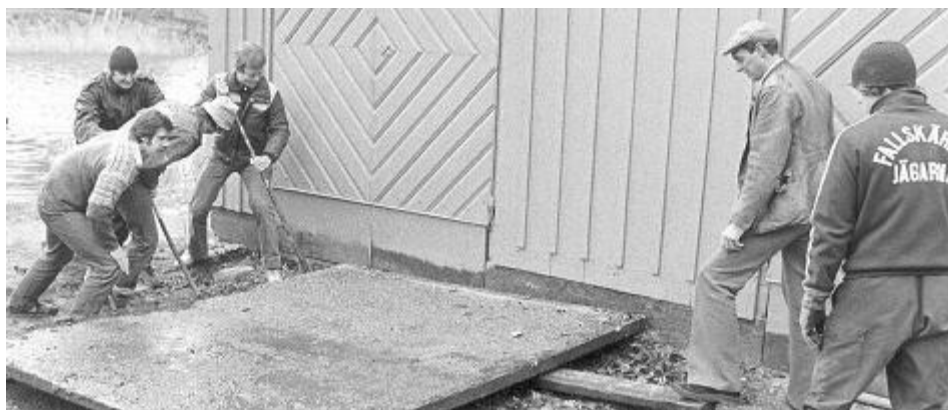
Plattornas höjd framför portarna justeras, även om man har kepsen på sig går det
